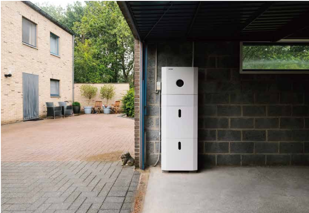
11 Progetto ESS residenziale in Belgio
